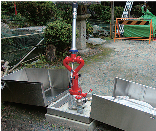
【写真2】放水銃・消火栓併設型
